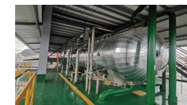
贵州盛屯300方高盐废水资源化项目
